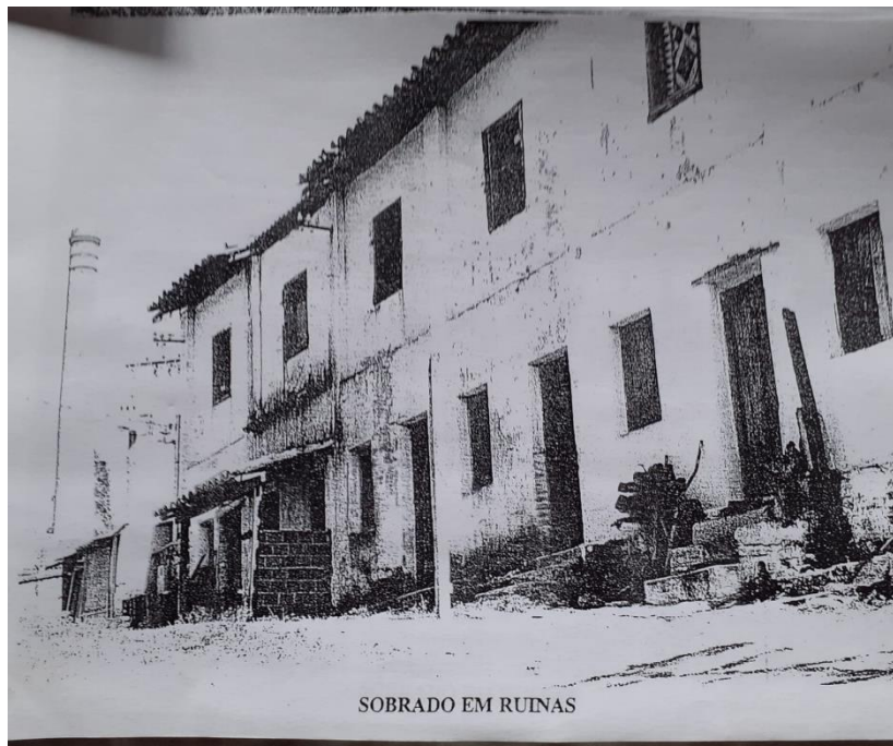
Figura 10 - Ruínas de sobrado em Marzagão
